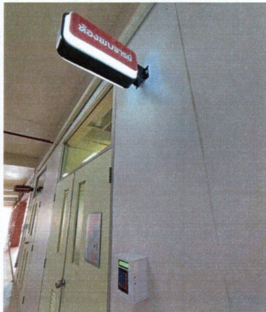
รูปที่ 8 บริเวณหน้าห้องพบอาจารย์ที่ติดตั้งระบบ UP O3P Key
